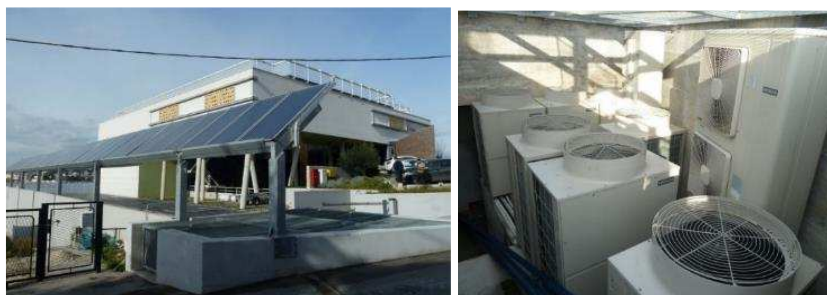
Slika 5-29 Solarni kolektori i vanjske jedinice VRV sustava
